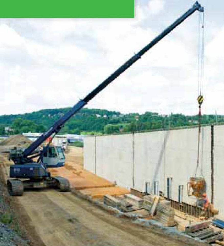
613 R – Lifting breasting boards – Cementation works on construction site; Germany 613 R – Einheben von Verschalungstafeln – Zementierungsarbeiten auf Baustelle; Deutschland
