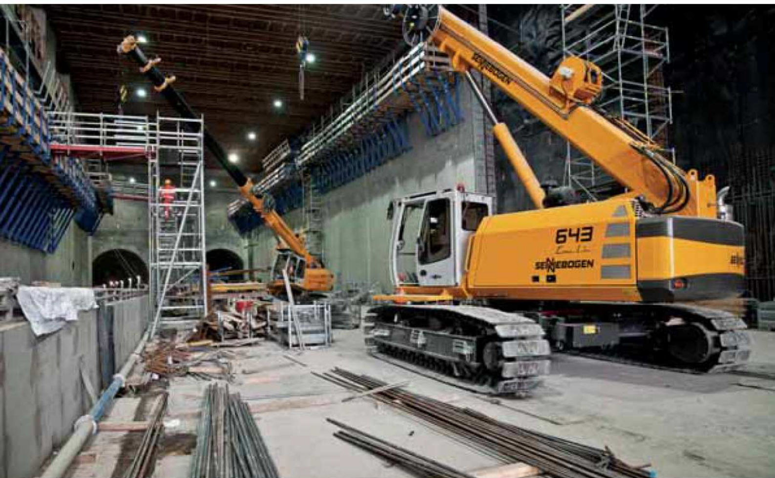
643 R – Hoisting works in tunnel construction site; Germany 643 R – Hebearbeiten im Tunnelbau; Deutschland
