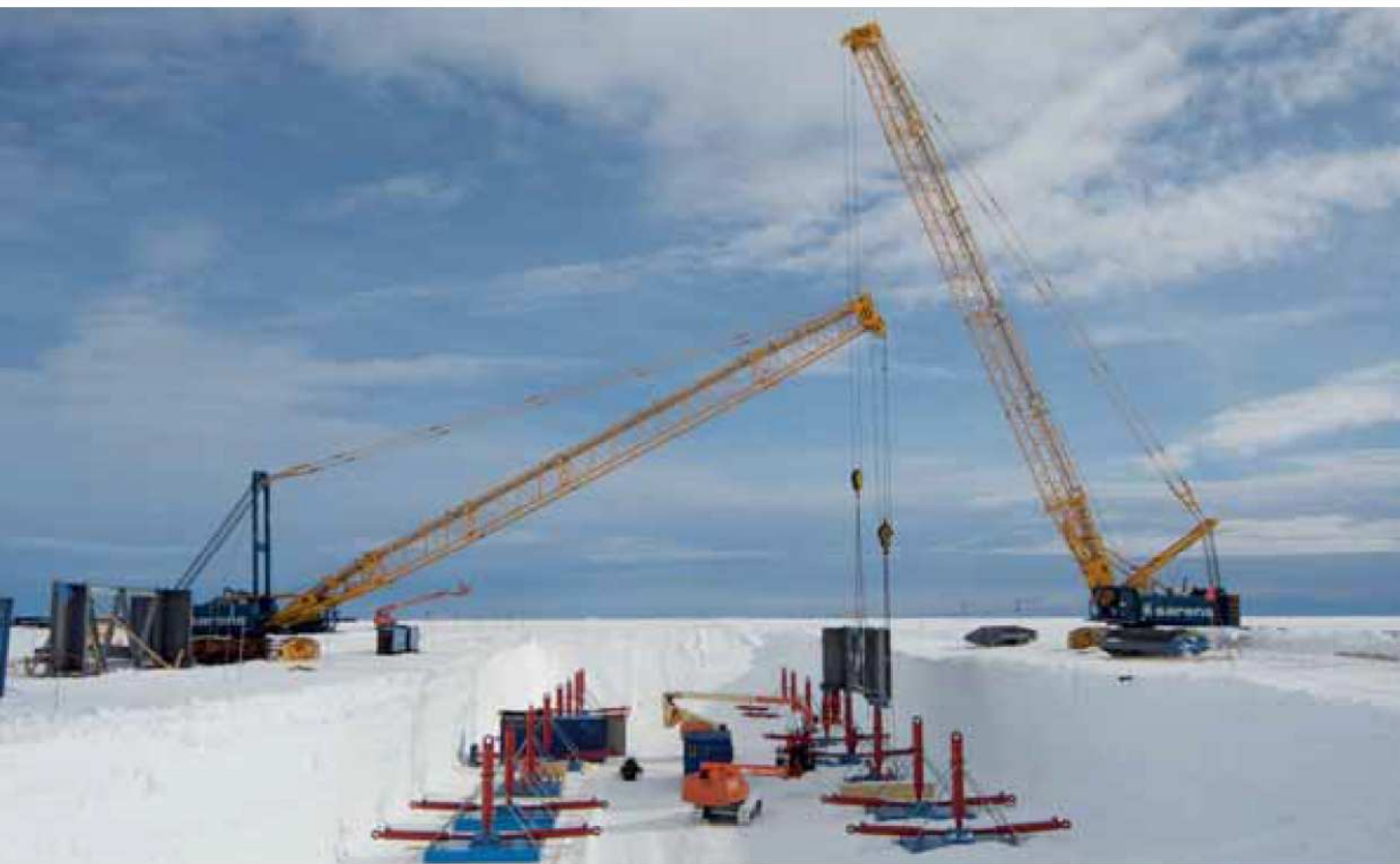
3300 - Construction works at polar research station Neumayer; Antarctica 3300 - Aufbau der Polarforschungsstation Neumayer; Antarktis
