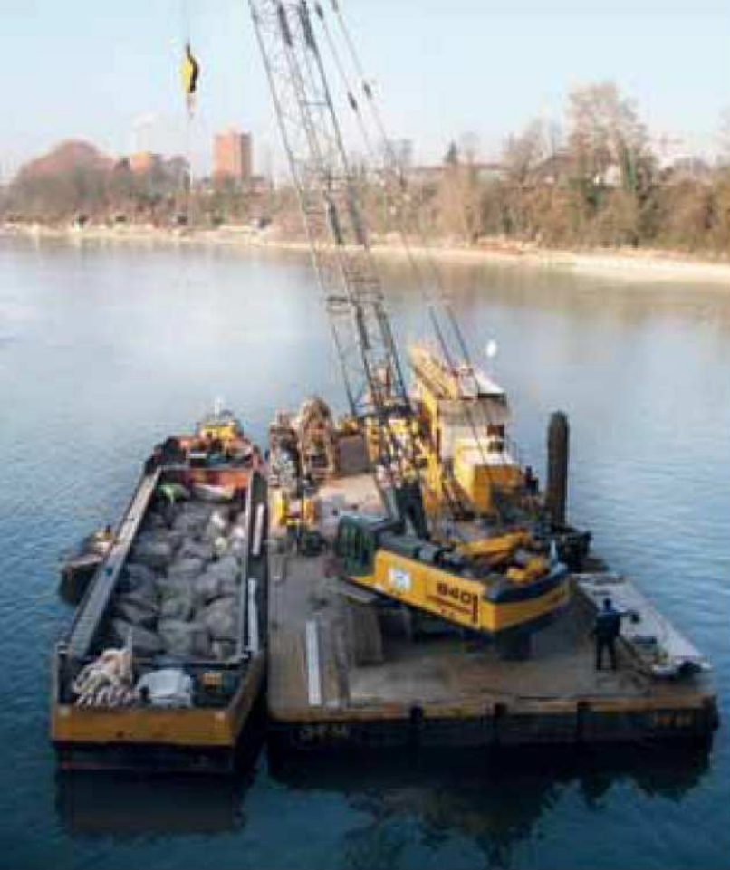
640 HD - Rock hoisting operation in hydro construction; Germany 640 HD - Stein-Hebeinsatz im Wasserbau; Deutschland
