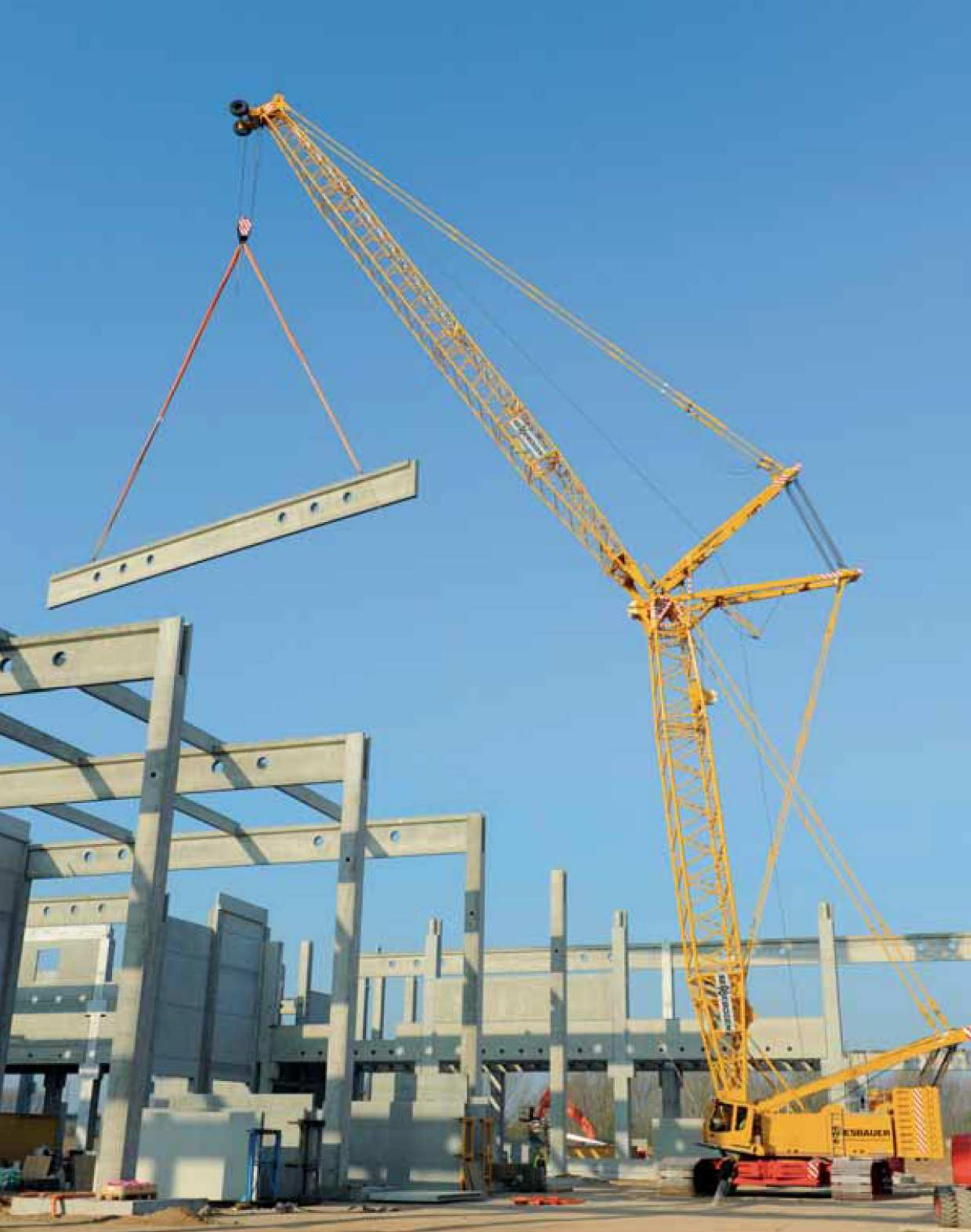
7700 - Hoisting works of concrete-prefabricated parts in building industrial works; Germany 7700 - Hebearbeiten von Beton-Fertigteilen im Industriebau; Deutschland
