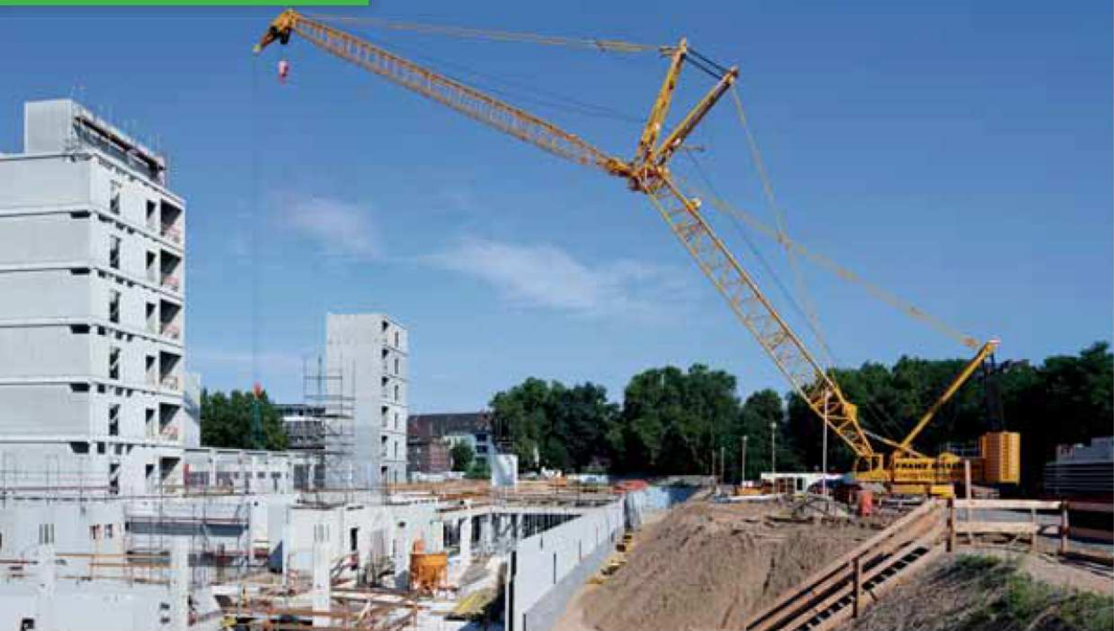
7700 - Hoisting works of concrete-prefabricated parts with auxiliary jib; Germany 7700 - Hebearbeiten von Beton-Fertigteilen mit Schnabelausleger; Deutschland
